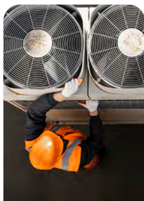
Sistemas de calefacción, ventilación y aire acondicionado
