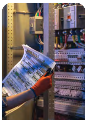
Sistemas eléctricos e hidráulicos
